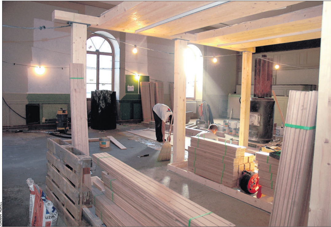
CHANTIER Les travaux d'aménagement de l'Espace Jules-Verne vont bon train, sous les combles du Café du Château: une mezzanine est en cours de construction, afin de disposer la collection sur deux étages.
